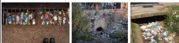
a-Desagües pluviales anegados
