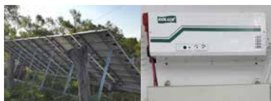
Ilustración 5: Instalación Isla sobre San Javier.
